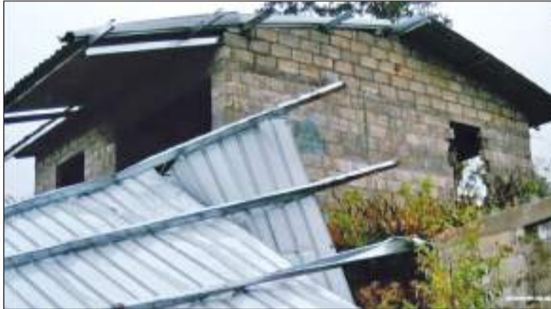
இடைநிறுத்தப்பட்டுள்ள அரைகுறையாக கட்டப்பட்டுள்ள வீடுகளின் சுவர் வெடிப்புக்
